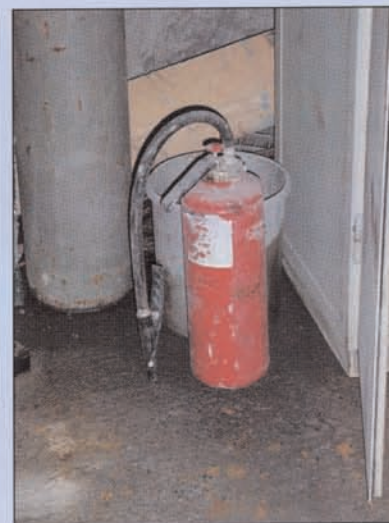
les extincteurs sont mis à forte contribution...
