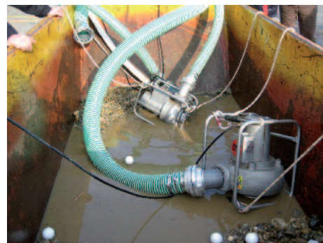
Mast-Schmutzwasserpumpen im harten Einsatz.
